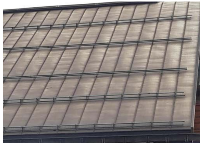
Eindeckung mit evidenten Spannungen durch ungeeignetes Befestigungsmaterial
